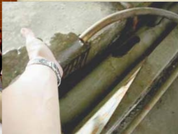
離心式中間段卻水洩漏
