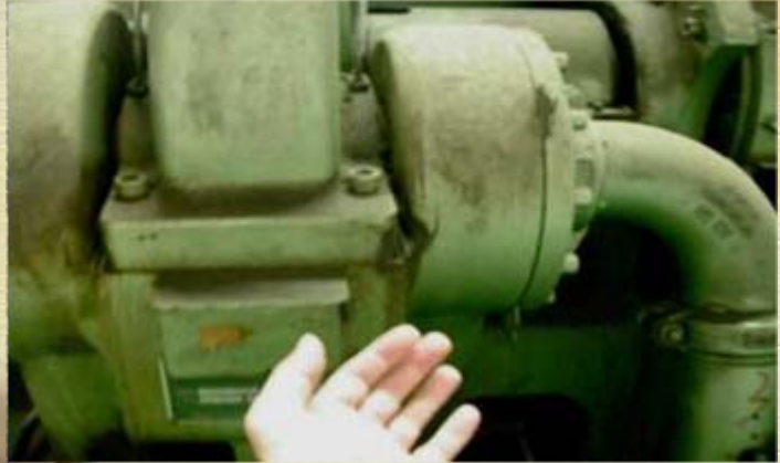
空壓機的內部洩漏
