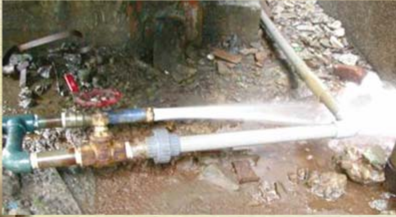
乾燥機的冷凝水排放洩漏
