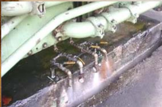
離心式中間段卻水洩漏
