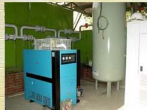
穩壓空氣桶與冷 凍式乾燥機
