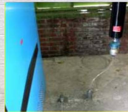
乾燥機及精密過濾器 - 卻水管路
