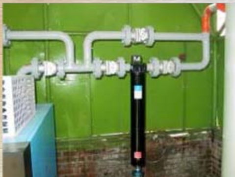
管路除塵過濾器 - 傍通管路
