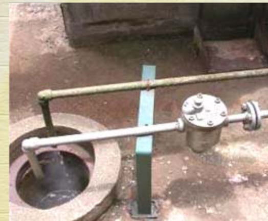
倒筒式卻水器排水洩漏
