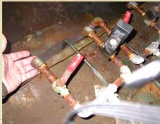
電子式卻水器排水洩漏
