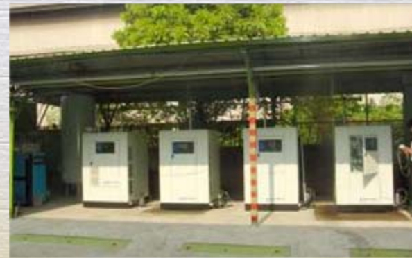
三台定頻螺旋空壓機搭 配一台變頻空壓機
