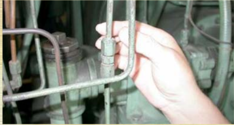
管路接頭不良造成的洩漏
