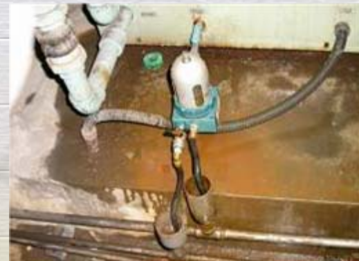
浮球式卻水器排水洩漏
